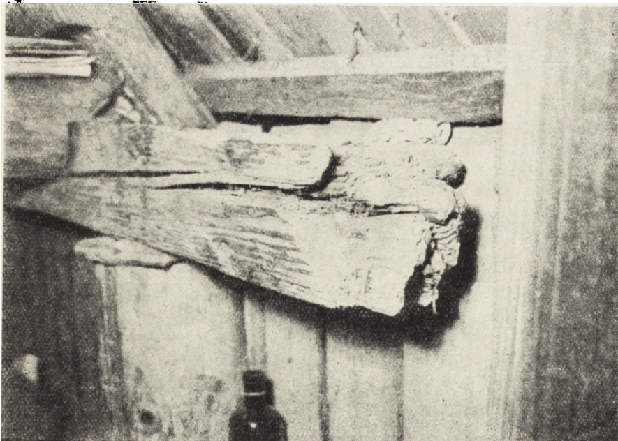
Ryc. 29. Kościół w Dębnie. Skutki destrukcyjnej działalności grzyba Lenzites sepiaria na końcu belki w sobocie. (fot. W. Galewski)
