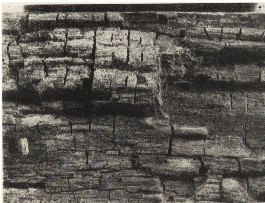
Ryc. 10. Zgnilizna destrukcyjna drewna. (fot. W. Galewski)
