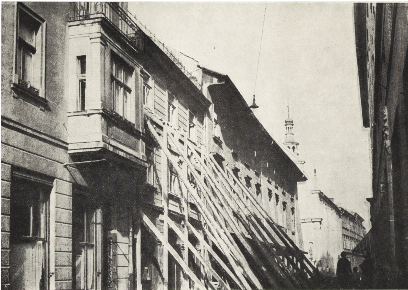
Ryc. 1. Kraków, ul. Solskiego, domy zagrożone zawaleniem i przeznaczone do rozbiórki. (fot. Politechnika Krakowska Wydż. Arch.)
