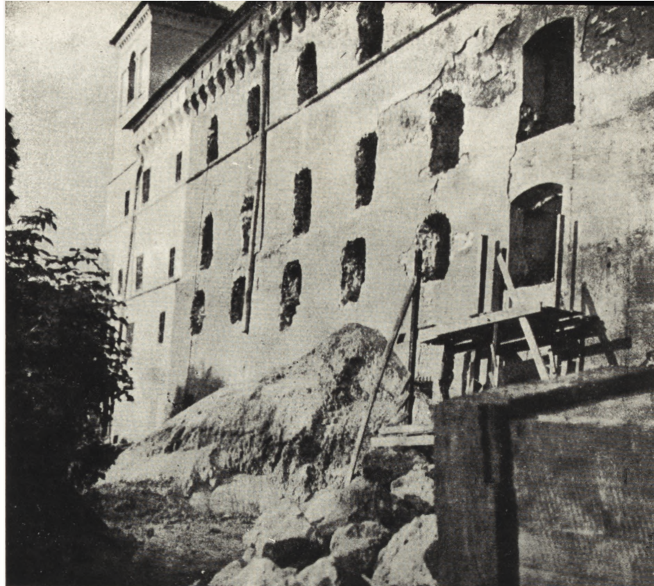
Ryc. 3. Kraków, Dawne więzienie św. Michała w trakcie przebudowy na pomieszczenie Muzeum Archeologii i Geologii. (fot. W. Nowak)
