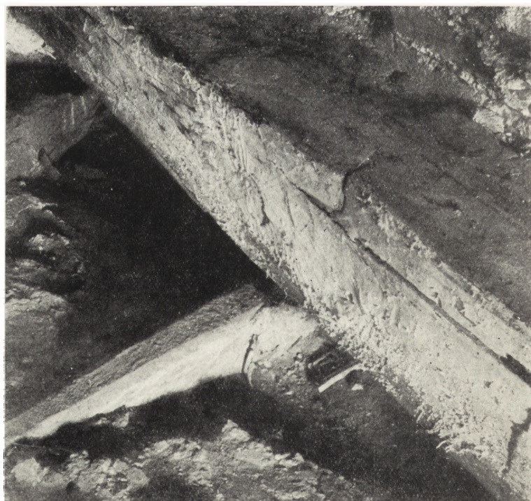
Ryc. 3. Stan zniszczenia i zagrzybienie jednej z belek stropowych (fot. A. Stelmach)
