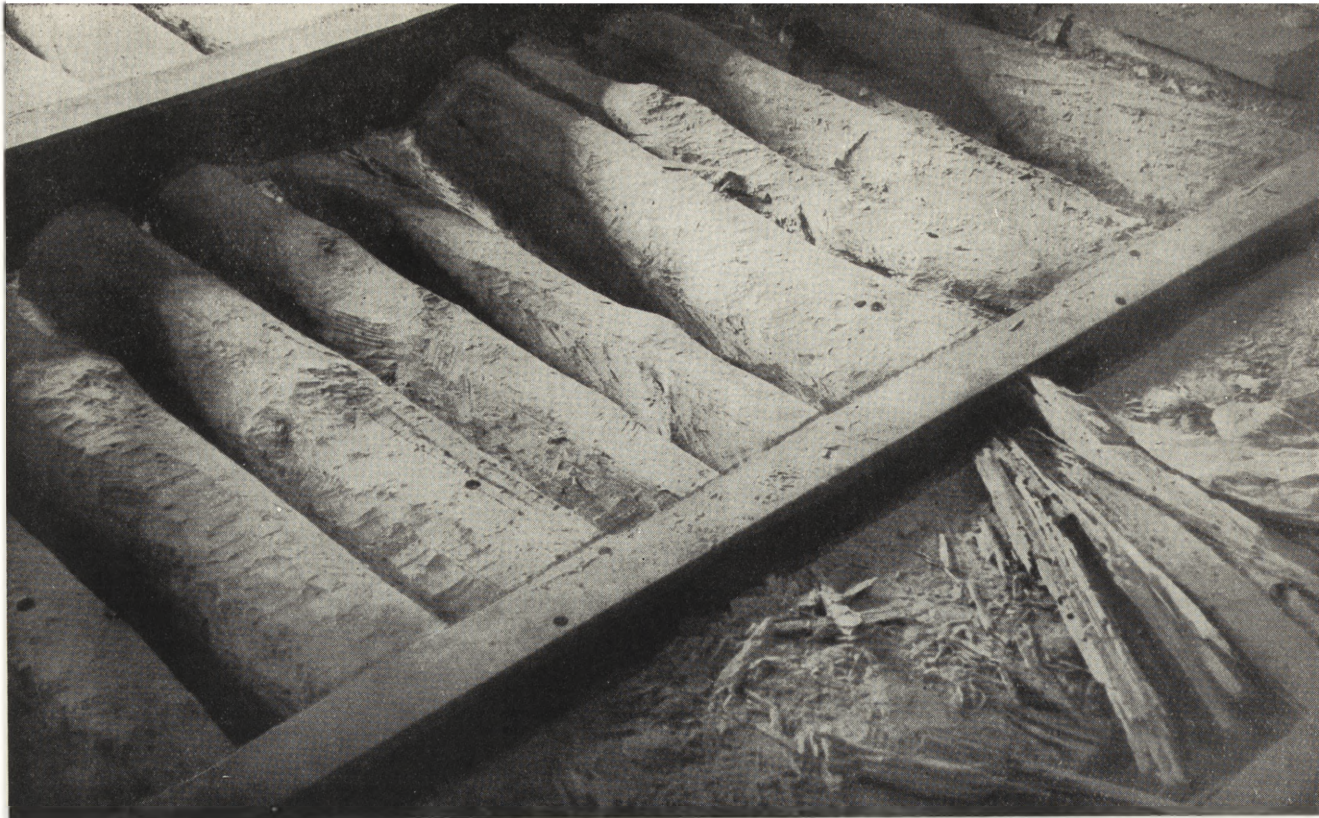
Ryc. 1. Stan zniszczenia belek stropowych
