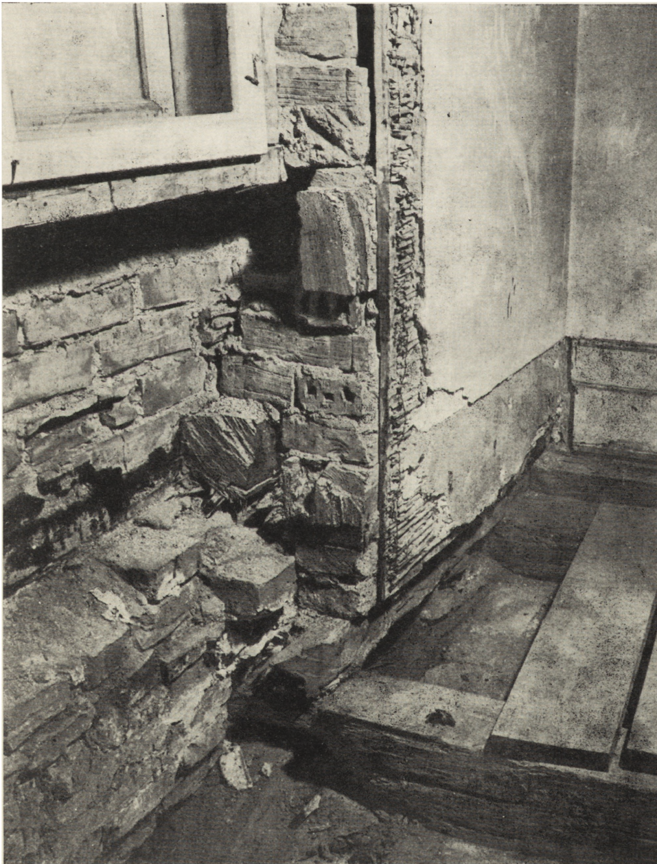
Ryc. 14. Warszawa — Łazienki, Biały Domek, wnętrze — stan przed konserwacją. Widoczna konstrukcja ściany (cegła, drewno, wypełnienie proszkiem, torfem i słomą)
