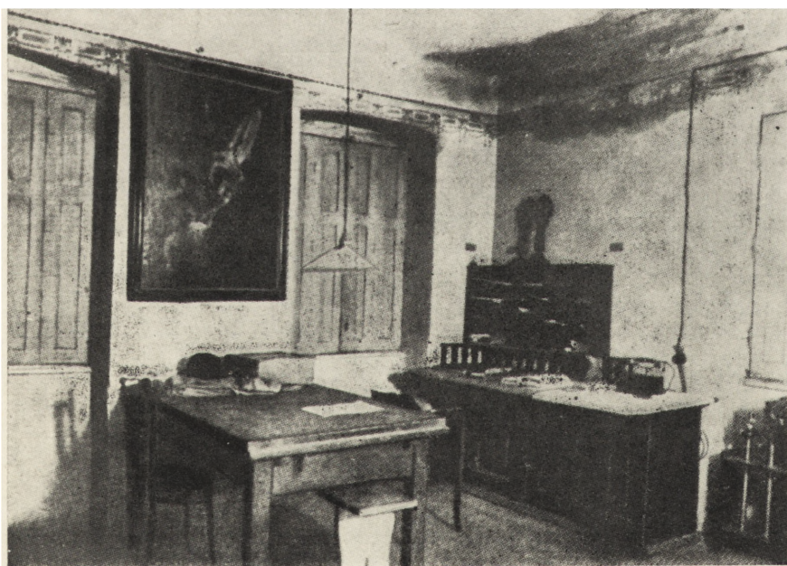
Ryc. 4. Płyty izolacyjne wewnątrz pomieszczenia były przyczyną podniesienia się wilgoci aż do sufitu („Zement und Beton” 9, 1957)
