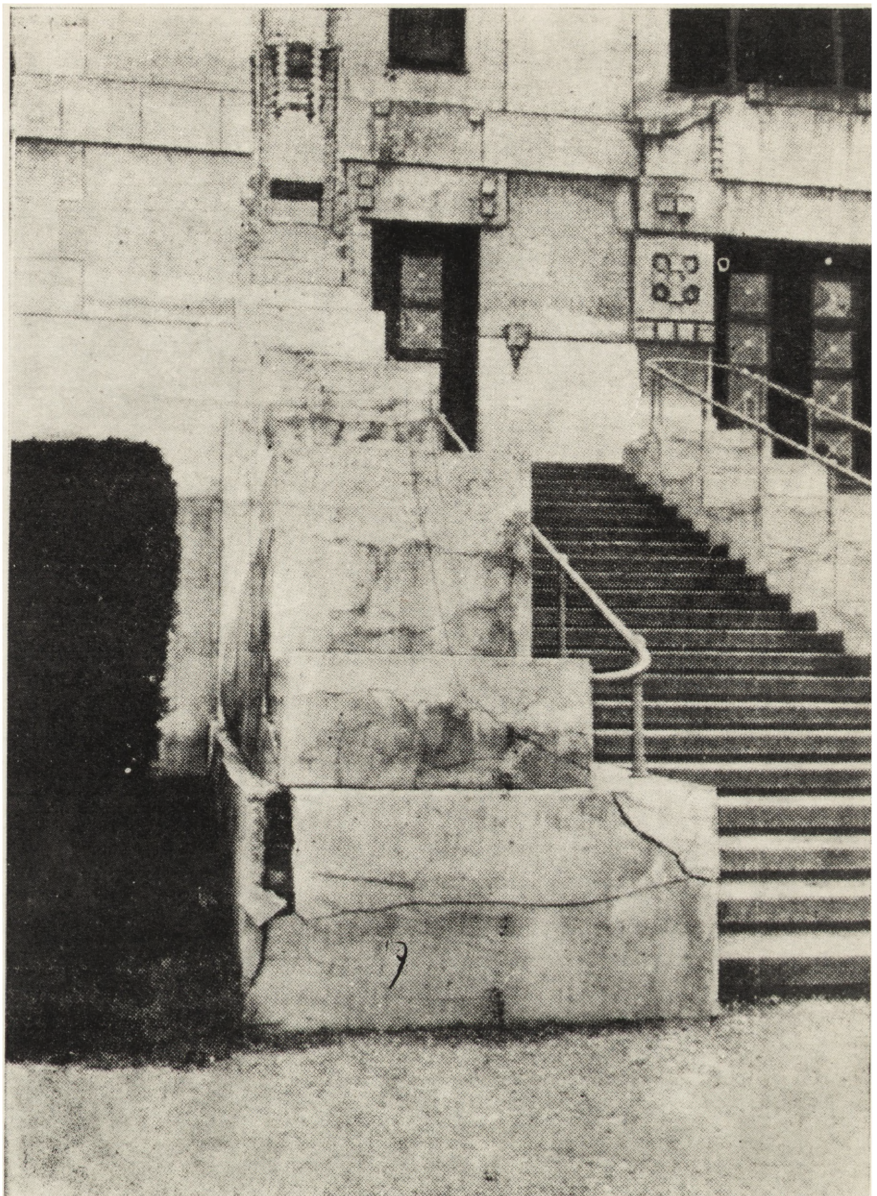
Ryc. 2. Mur. ceglany z wyprawą cementową. Odpadanie wyprawy całymi płytami („Zement und Beton” 9, 1957)
