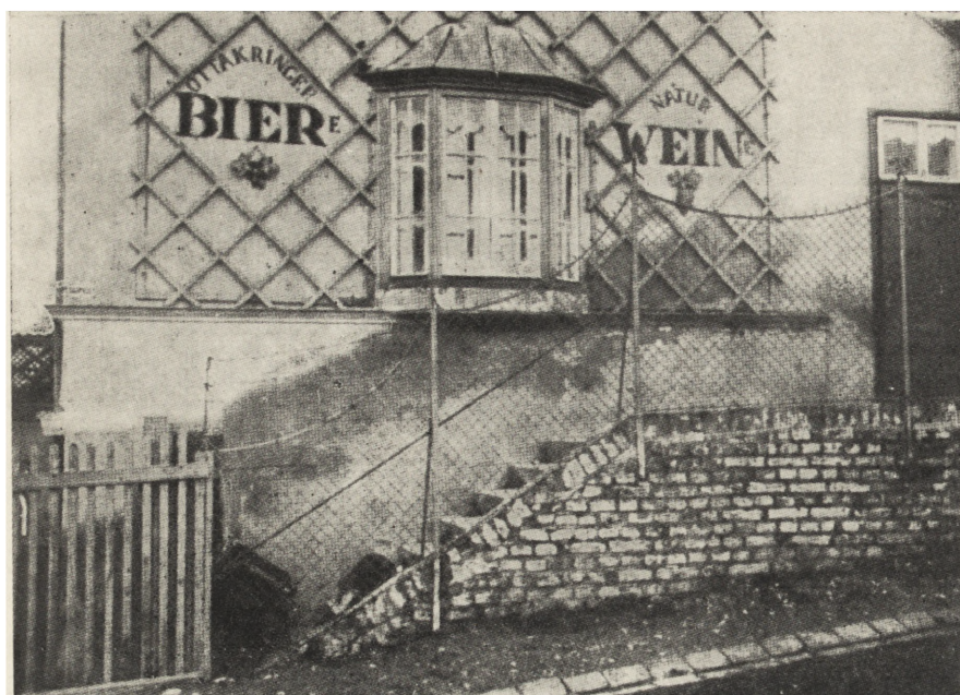
Ryc. 3. Wilgoć wznosi się za biegiem schodów („Zement und Beton” 9, 1957)
