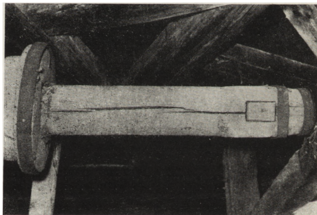
35. Tyńiec. Klasztor oo. benedyktynów. Studnia — na wale wyciągu widoczny zaklinowany otwór, pozwalający przypuszczać, że tutaj kiedyś musiało się znajdować koło napędowe, stan z 1965 r. (fot. A. Salażiak)
