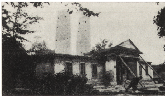
25. Świątkowice (pow. Wieluń). Dwór drewniany. Widok ogólny, stan z 1965 r. podczas restauracji (fot. H. Pracuta)
