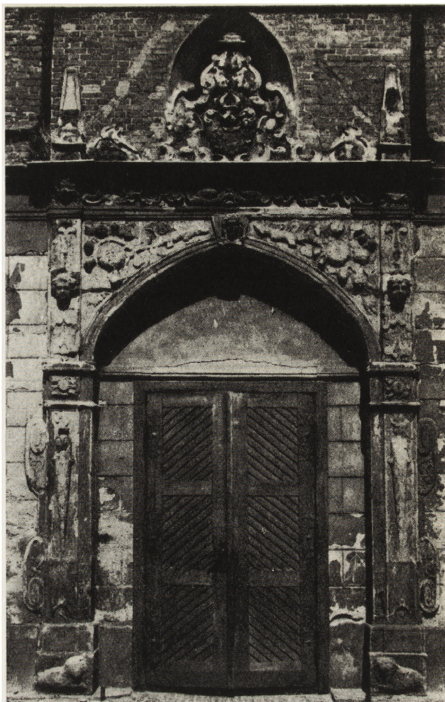
6. Grudziądz. Portal Działyńskich w kruchcie kościoła parafialnego. Ostatnia faza rozpadu faktury powierzchni przed ostatecznym zaniknięciem plastycznych wartości detali (fot. Waclaw Górski)
