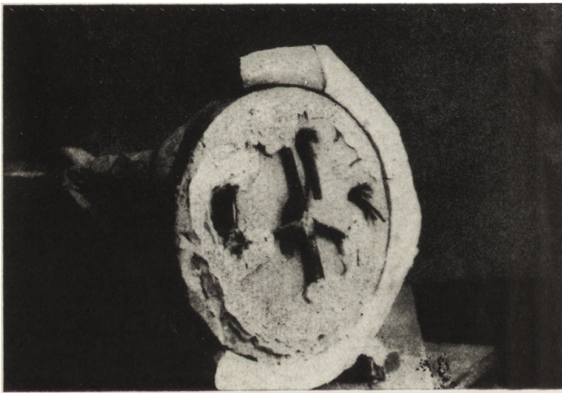
4. Posąg Wenus — formowanie dodatkowej podstawy konstrukcyjnej; widoczne kawałki stali, przyspawane promiennie do prętów stanowiących uzbrojenie partii nóg
