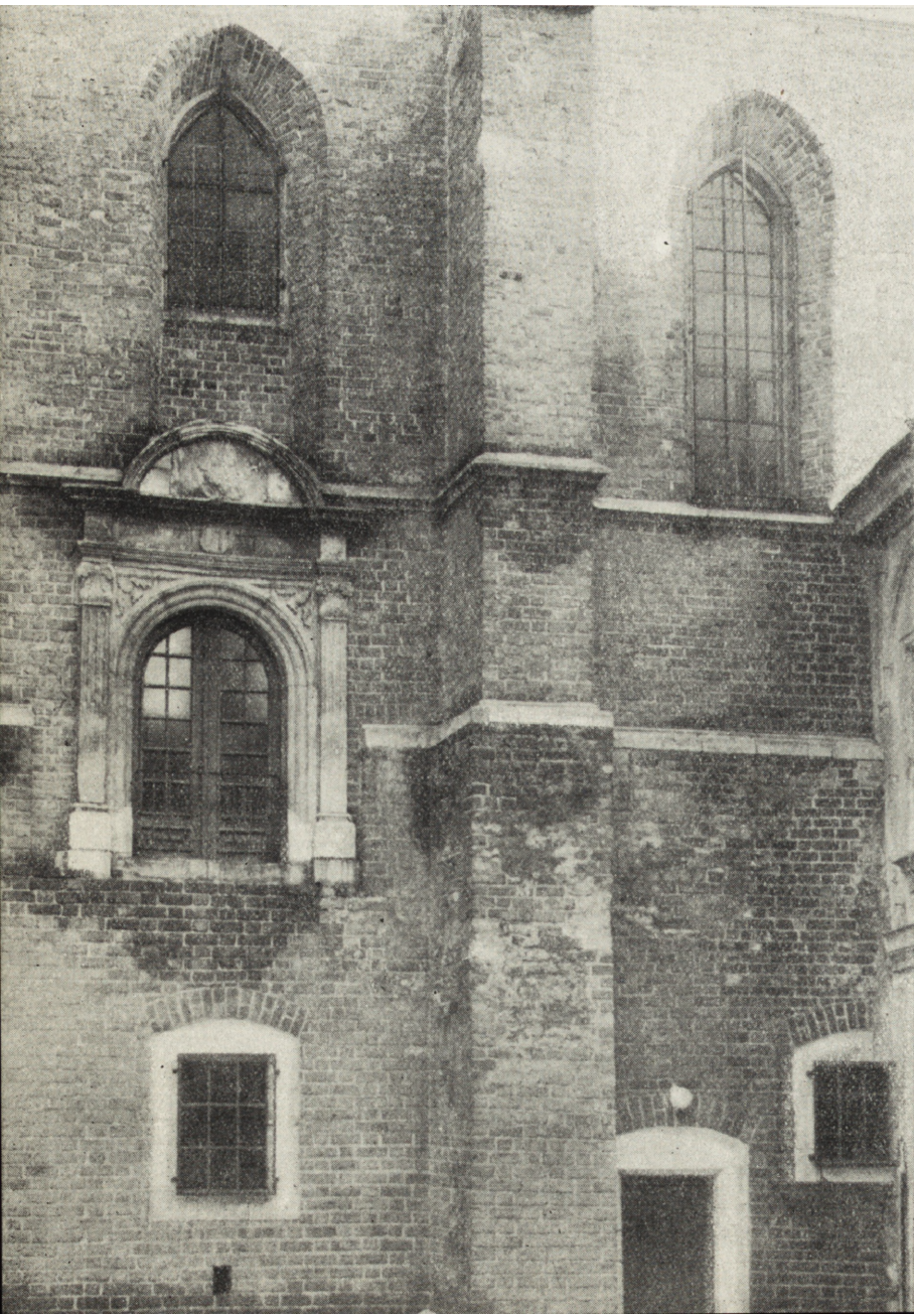
14. Lublin, kaplica zamkowa, zawilgocenie murów przy detalach kamiennych na elewacji zachodniej (fot. W. Górski)
