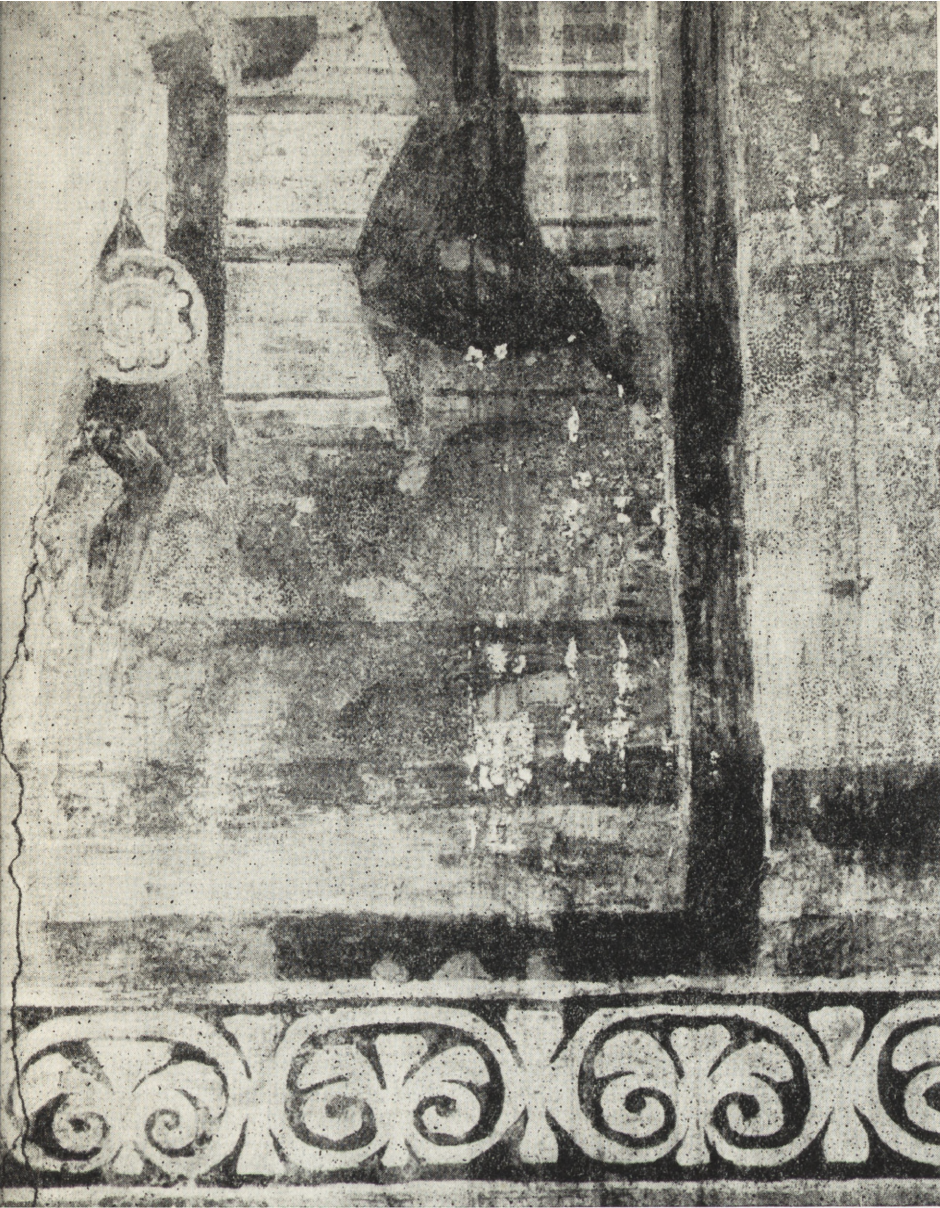
10. Lublin, kaplica zamkowa, fragment malowidła z prezbiterium z charakterystycznymi zaciekami i złuszczeniami farby, spowodowanymi spływaniem wody z powierzchni szyb, stan z lutego 1968 (fot. W. Górski)
