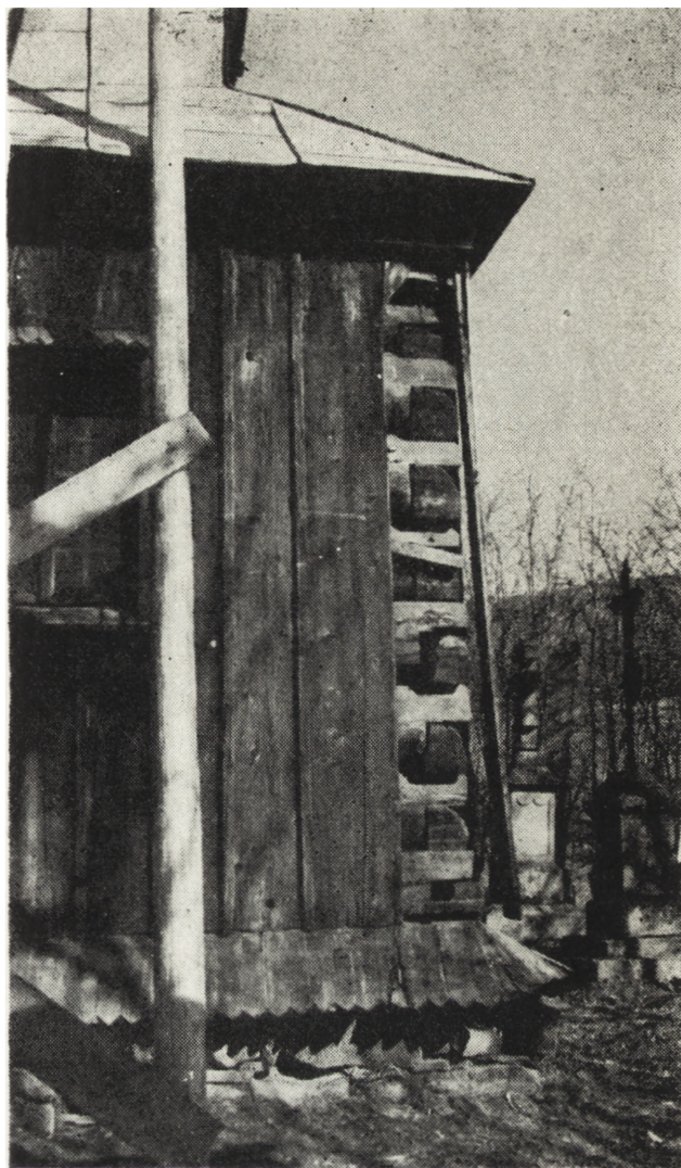
4. Krempana, cerkiew, pd-wsch. narożnik prezbiterium z odstoniętym węglem (fot. A. Hunicz)
