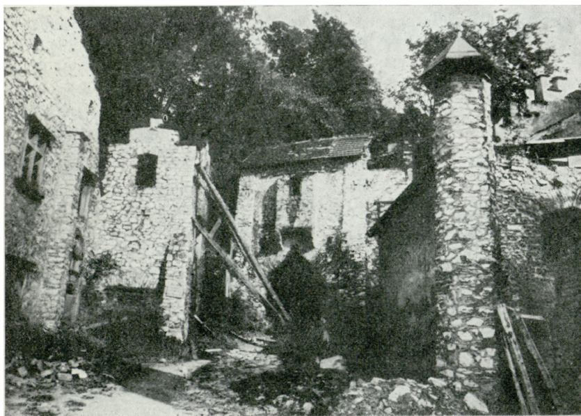
14. Młoszowa, zespół pałacowo-parkowy, zagrożone budowle romantyczne, stan w początkowej fazie prac zabezpieczających w 1960 r., (fot. T. Chrzanowski)
