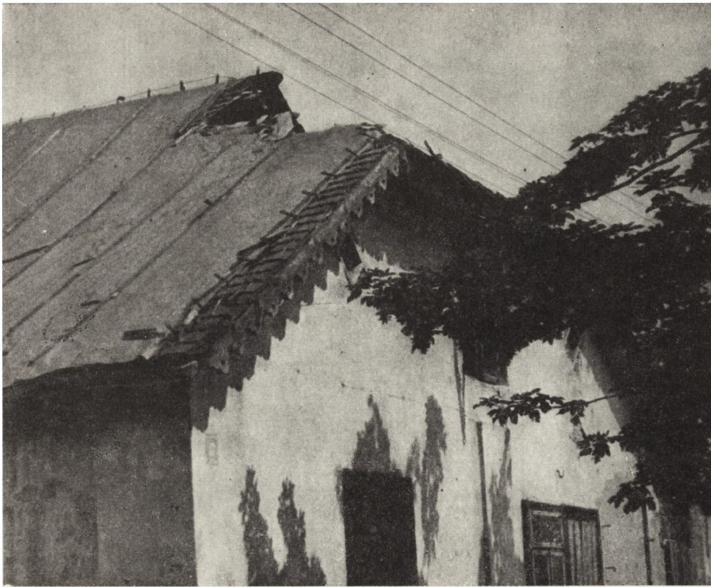
5. Niemce, pow. Lubartów. Dawny dwór, fragment wyciętego dachu pod przewody elektryczne w 1973 r. (fot. R. Brykowski)
