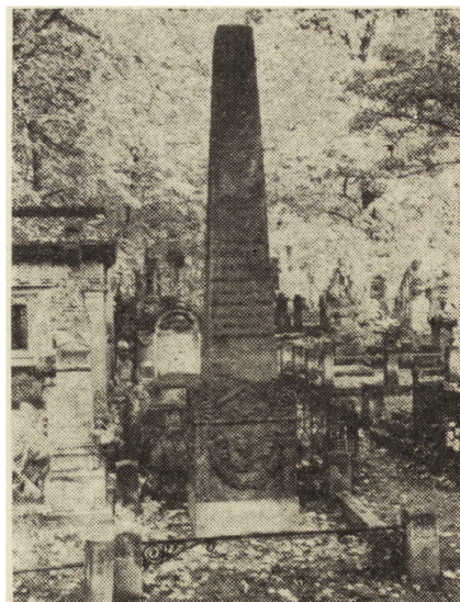
12. Cmentarz na Powązkach, nagrobek gen. Michała Włodka: a — w czasie konserwacji (fot. A. Stasiak), b — po konserwacji (fot. K. Kowalska)
