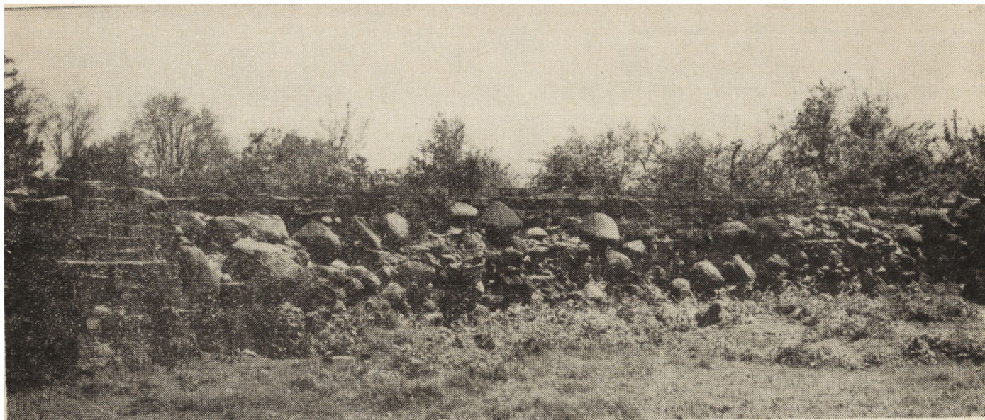
7. Wińsko (woj. wrocławskie), odcinek kamiennych murów obronnych — stan kompletnej destrukcji z nieudaną próbą zabezpieczenia korony murów warstwą płasko kładzionych cegieł
