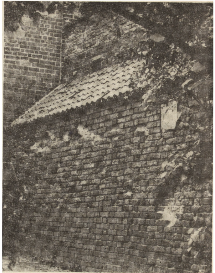
4. Syców (woj. kaliskie), odcinek ceglanych murów obronnych — przykład zabezpieczenia korony daszkiem pulpitowym z dachówki korytkowej
