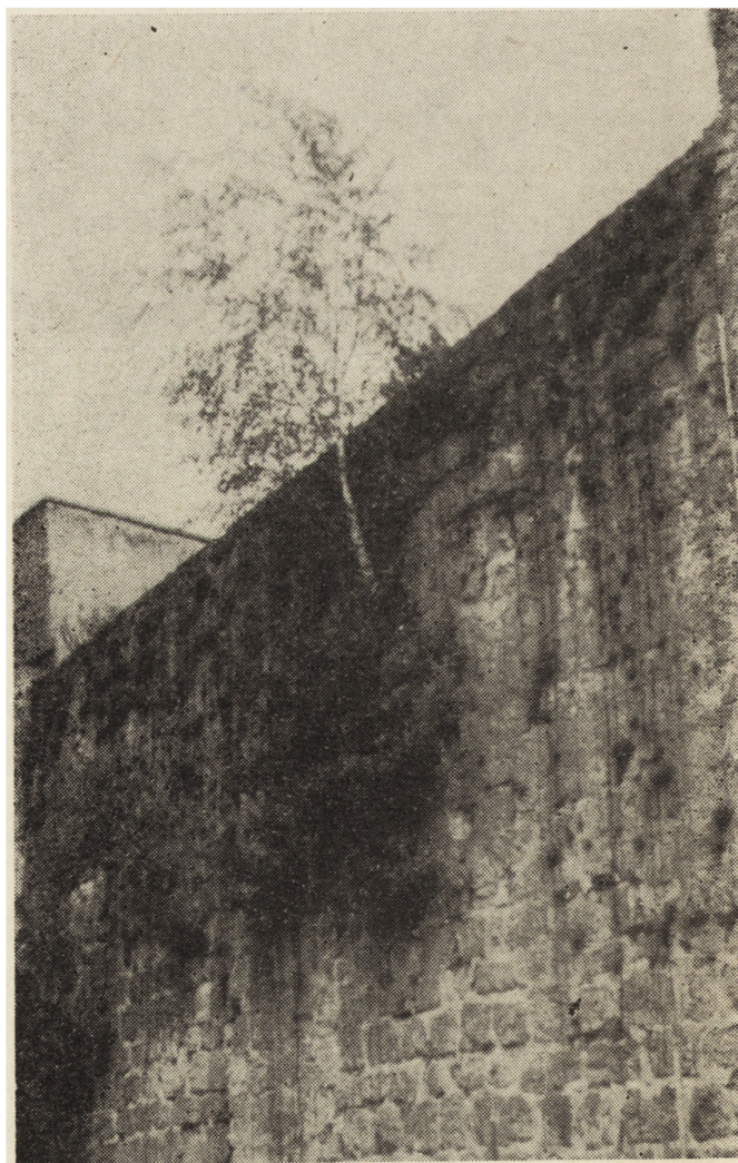
11. Lwówek Śl. (woj. jeleniogórskie), mury kamienne — przykład destrukcji lica pionowego (!) przez krzewy, a nawet kilkuletnią brzoźkę wyrastającą z lica muru (fot. M. Przylęcki)
