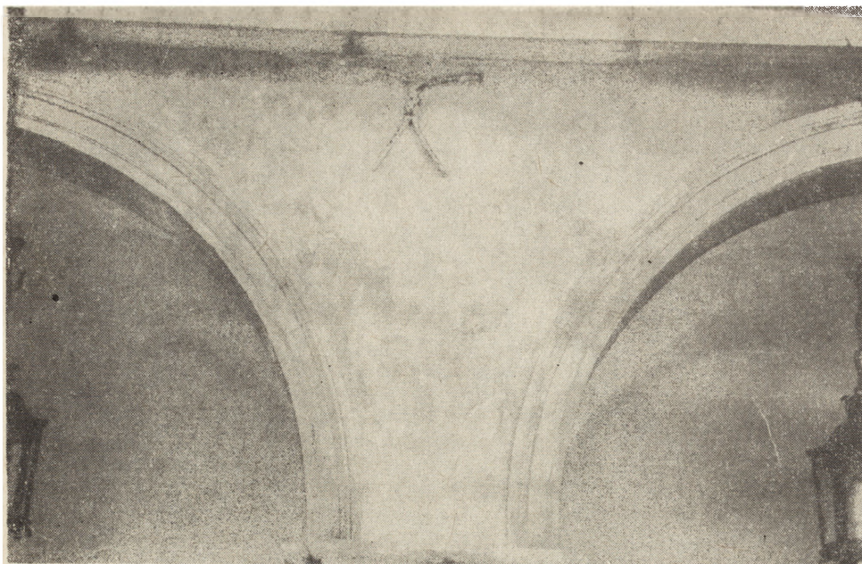
3. Otwok Stary, fragment arkadowego podcienia w południowej elewacji pałacu — wykwit na tynku cementowo-wapiennym, wykonanym na starym murze
