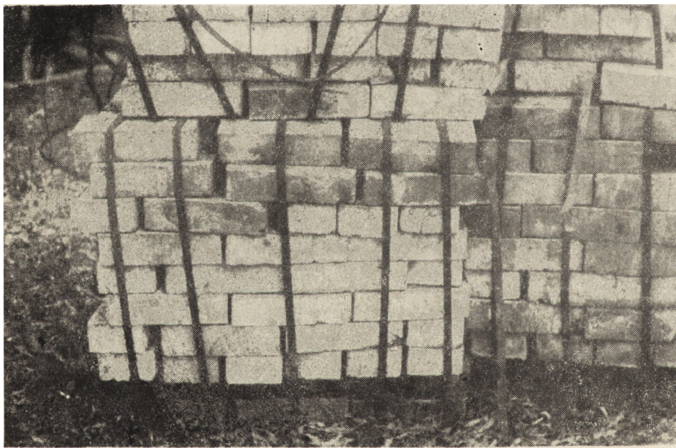
4. Zaszolenia występujące na powierzchni nowej cegły, składowanej na budowie przez pół roku
