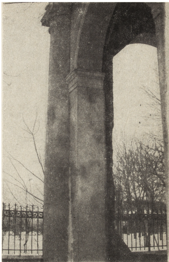
5. Karczew k. Warszawy, fragment dzwonnicy — wykwiły na tynku spowodowane oddziaływaniem soli zawartych w nowej cegle użytej do szpałdowania i flekowania podpór budowli (wszystkie zdjęcia autora)
