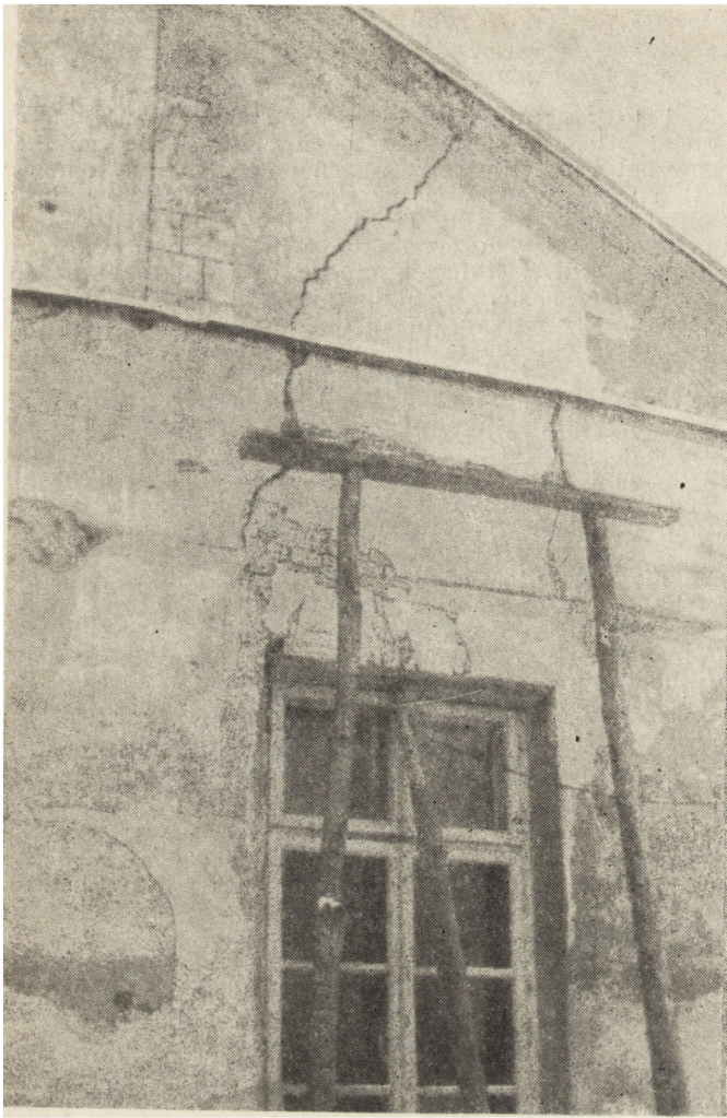
1. Pogorzel k. Mińska Mazowieckiego, fragment wschodniej elewacji pałacu — rysy spowodowane brakiem usztywnień przestrzennych budynku (rozebrane stropy) oraz zmianą warunków posadowienia
