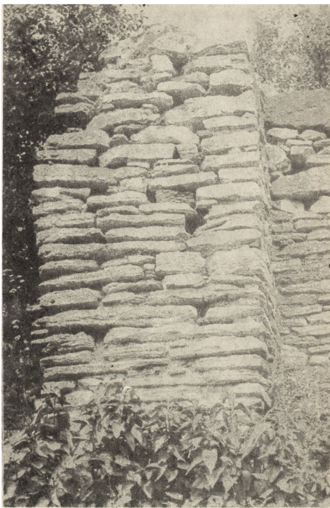
2. Sulejów, fragment murów obronnych opactwa cystersów od strony południowej — zmniejszenie spoiwości warstw muru spowodowane wypłukaniem zaprawy ze spoin
