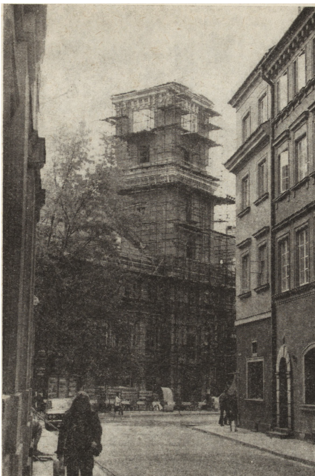
10. Mury Wieży Zegarowej z osadzonymi tarczami zegara gotowe do montażu hełmu (fot. A. Pulikowski)
