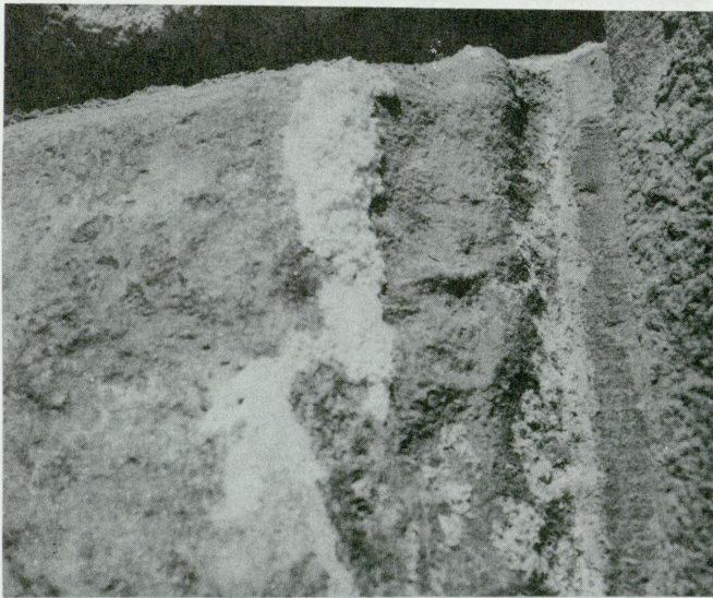
2. Krystalizacja soli, powstających w zanieczyszczonym środowisku – Kraków, Wawel, mur wokół katedry (fot. P. Stępień)
