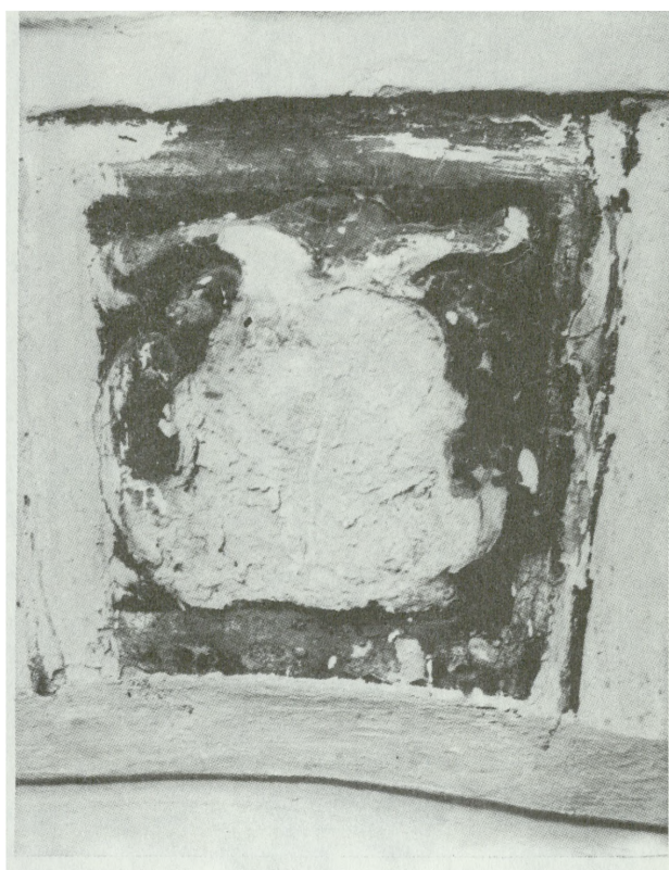
13. Fasada kamienicy przy ul. Piwnej 1 w Gdańsku. Rzeźba przed konserwacją 13. The facade of the house at 1 Piwna Street in Gdańsk. A sculpture before conservation.
