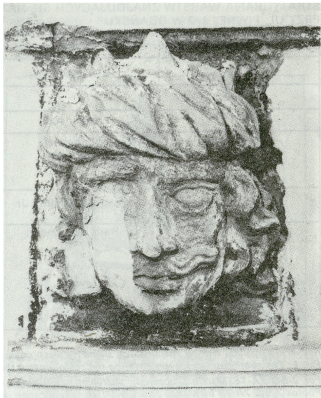
8A. Fasada kamienicy przy ul. Piwnej 1 w Gdańsku. Rzeźba przed konserwacją 8A. The facade of the house at 1 Piwna Street in Gdańsk. A sculpture before conservation.
