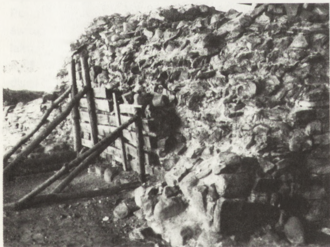
2. Ostrów Lednicki. Tymczasowe zabezpieczenie osuwającego się muru aneksu
