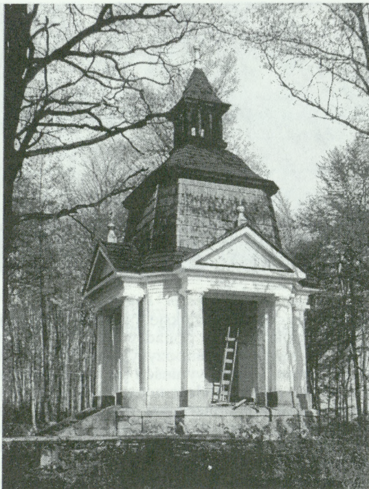
5. Cmentarz wojenny Nr 292 Lubcza Szczepanowska; proj. G. Rossmann. Kaplica pod koniec remontu, kwiecień 1989 5. Wartime cemetery no 292 Lubcza Szczepanowska; design by G. Rossmann. Chapel at completion of renovation, April 1989
