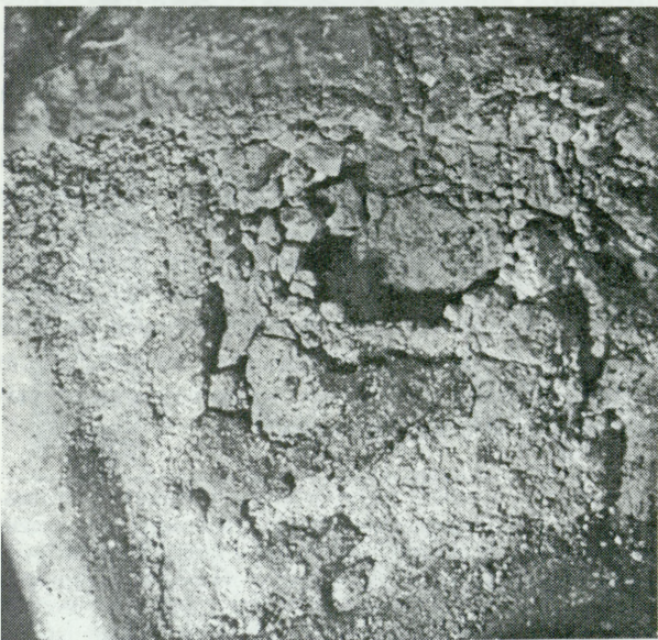
5. Wiślica, podziemia kolegiaty. Makrofotografia. Typowe uszkodzenia posadzki w niedekorowanej partii
