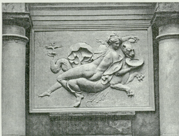
7. G. Staggi, Nadzieja karmiąca Chimere , płaskorzeźba na Przybytku Arcykapłana po konserwacji, 1994 r. Fot. W. Piwkowski
