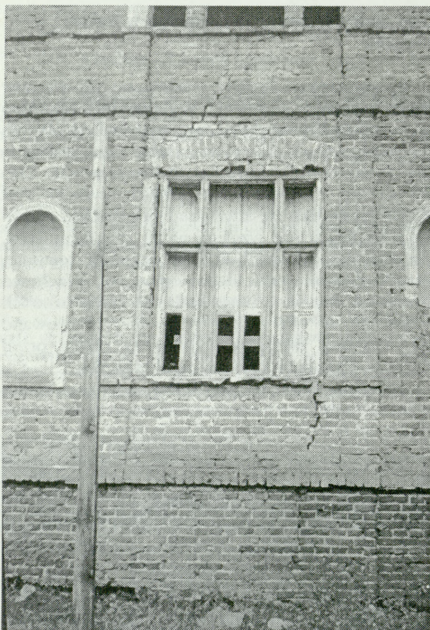
3. Fragment ściany zewnętrznej z widocznymi uszkodzeniami muru
