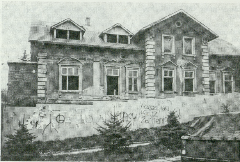
Kazimierza Wielka, budynek zarządu cukrowni „Łubna”, fasada — podczas remontu. Fot. O. Chojnacki 1993 r.
