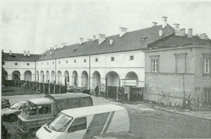
Kielce, pałac pobiskupi, skrzydło pn. — podczas remontu fasady. Fot. W. Siudowski 1993 r.
