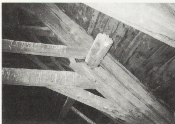
6. Osiadanie słupa leżącego na skutek uszkodzeń murlaty i końcówki krokwi przy podporze. Fot. P. Rapp
