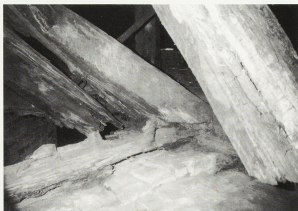
7. Skrzyżowanie nawy głównej z prawym transeptem. Całkowite zniszczenie murlaty, końcówek krokwi i słupów leżących — brak podpór, zagrożenie bezpieczeństwa. Fot. P. Rapp
