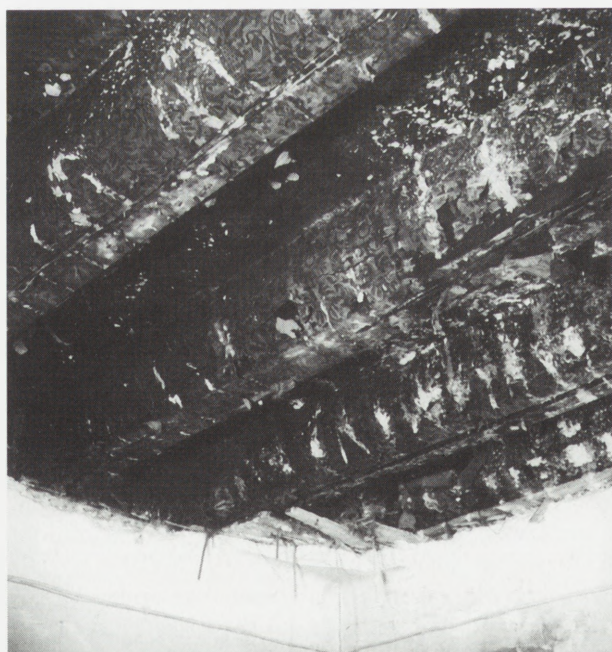
6. Strop pierwszego piętra w budynku przy ul. Floriańskiej 25 w Krakowie z zachowanymi fragmentami papierowej koltryny z XVII w., widoczne białe plamy wapna na koltrynie. Stan przed konserwacją. Fot. J. Charytoniuk
