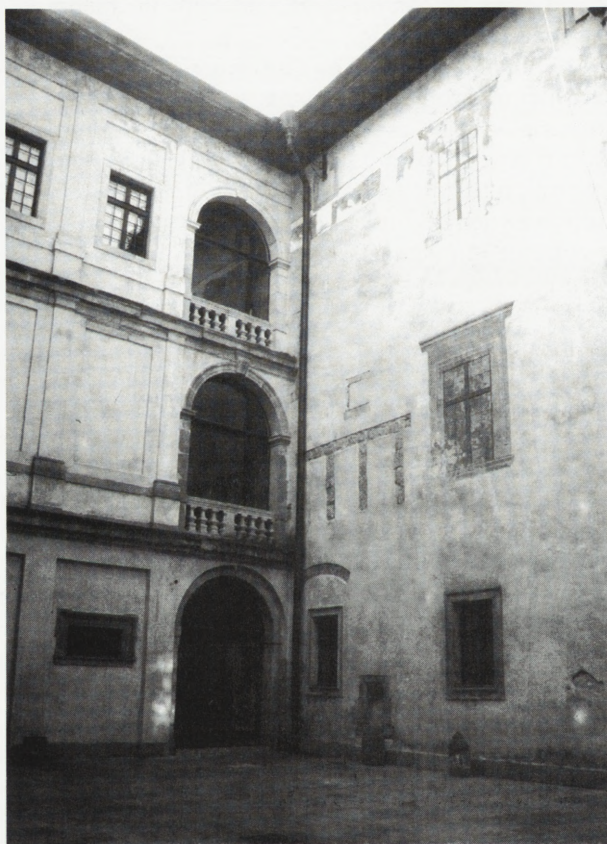
6. Malowane iluzjonistyczne okna wraz z chaotycznie rozmieszczonymi odkrywkami ukazującymi obramienia otworów okiennych z wcześniejszych faz budowlanych (Wiśnicz, zamek, fragment dziedzińca zamkowego). Fot. J. Lewicki 1997
