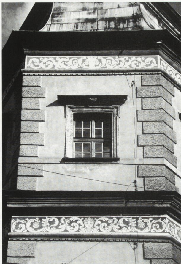
15. Błędnie zrekonstruowana stolarka o podziale rokokowym (szczeblina krzyżowa, szyby mocowane na kit) i konstrukcji skrzynkowej, która miała nawiązywać do okien z 1 poł. XVII w. (Kielce, Pałac Biskupi, wieża płn.-wsch.). Fot. J. Lewicki 1996
