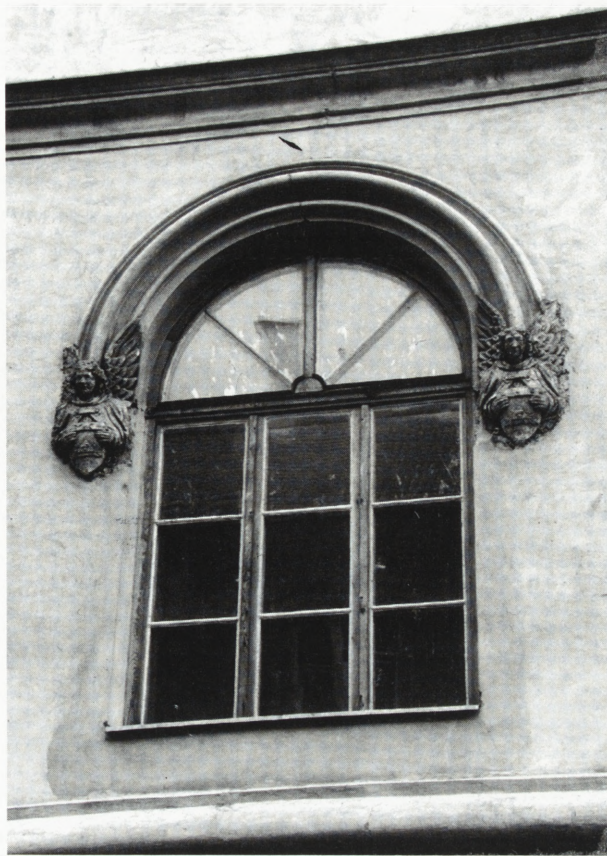
23. Uproszczona kopia stolarki w zachowanym oryginalnym obramieniu. Nieudolność rozwiązania wynika z niskiej jakości wykonawstwa i nieopanowania rzemiosła przez wykonujących okno rzemieślników (Warszawa, tzw. Dom Gaya z 1 poł. XIX w.). Fot. J. Lewicki 1998
