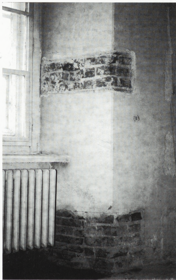
8. Ślady po otworach na zamki wewnętrznych okiennic. U doł widoczne pogrubienie ścianki podparapetowej i zachowany tylko w tym miejscu fragment marmurowej posadzki wskazujący pierwotny poziom użytkowy wnętrza (Kielce, Pałac Biskupi, 2 Pokój Biskupi, ok. 1644 r.). Fot. J. Lewicki 1996
