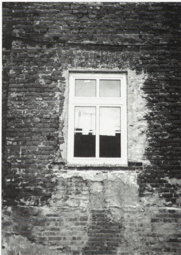
10. Widoczne dzięki usunięciu tynku z elewacji kolejne przekształcenia otworu okiennego. (Łęczyca, XIX–XX w.). Fot. J. Lewicki 1997
