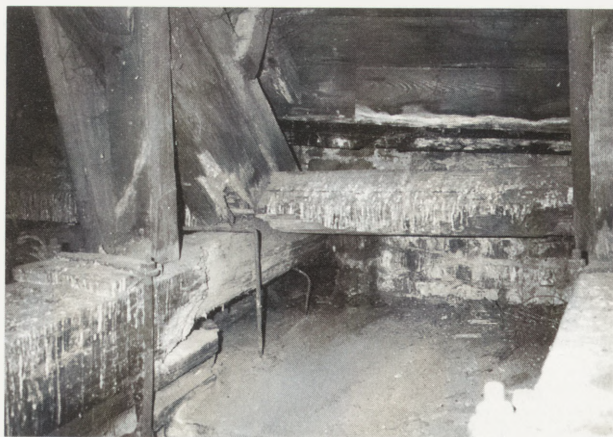
10. Uszkodzona podpora więzara dachowego. Fot. P. Rapp 10. Damaged support of roof truss. Photo: P. Rapp
