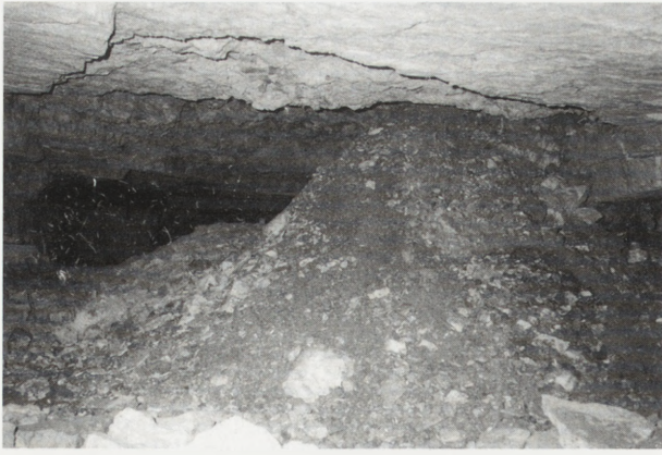
1. Spękania odpowierzchniowe niszczą stropy wyrobisk neolitycznych, grożąc zawaleniem podziemi. Wszystkie fot. W. Borkowski
