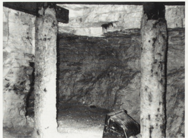
3. Zabezpieczenia trasy turystycznej wymagają już miejscami remontu
