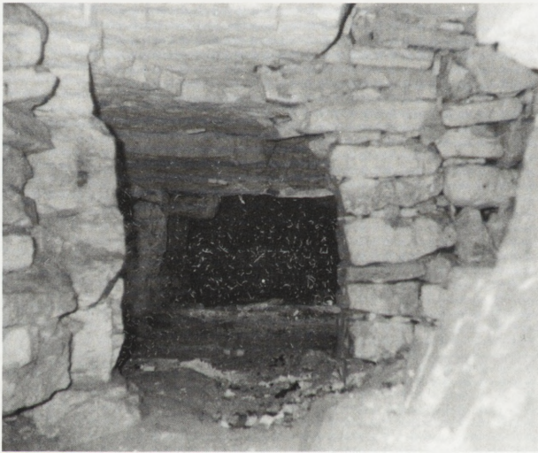
2. Zabezpieczenia wyrobisk z lat pięćdziesiątych poddają się z czasem działaniu procesów wietrzeniowych
