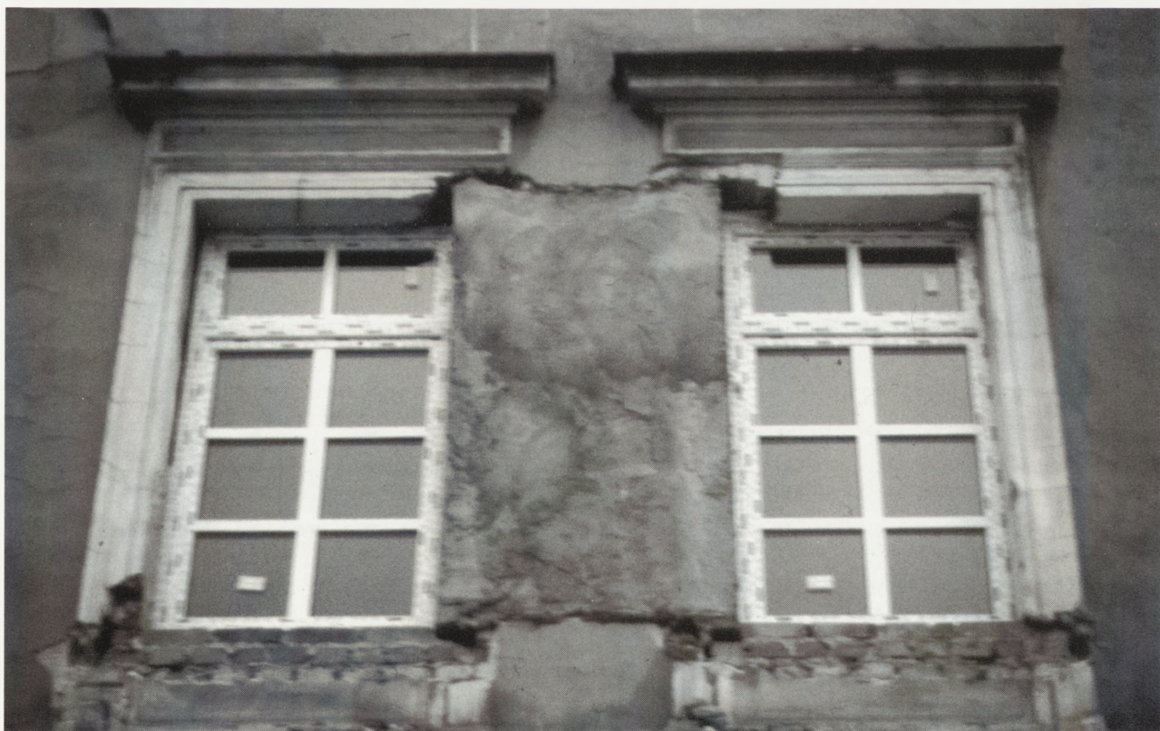
2. Prace remontowe mogą być okazją zarówno do odtworzenia okna i jego kolorystyki, jak i do zniszczenia zabytkowego rozwiązania. Usunięte zabytkowe okna wraz ze zniszczonym obramieniem okiennym i wstawione na to miejsce nowe plastikowe okna (Kraków, Stare Miasto, kamienica mieszczańska). Fot. J. Lewicki, 1999 r.
