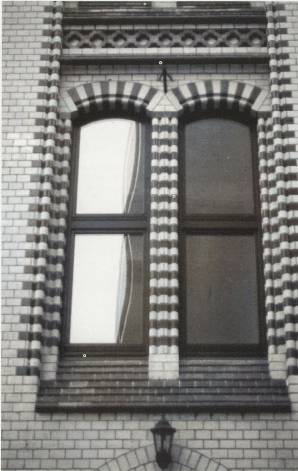
11. Współczesna plastikowa stolarka o podziałach nie mających nic wspólnego z podziałami historycznymi w oryginalnym obramieniu z glazurowanej barwionej cegły. Mimo odtworzenia kolorystyki ahistoryczność podziału (jednoramowe okno szklone jedną taflą) ztraca wartości architektoniczne fasady budynku. (Wrocław, Ostrów Tumski, jeden z zespołu budynków kościelnych na południowy wschód od katedry). Fot. J. Lewicki, 1999 r.
