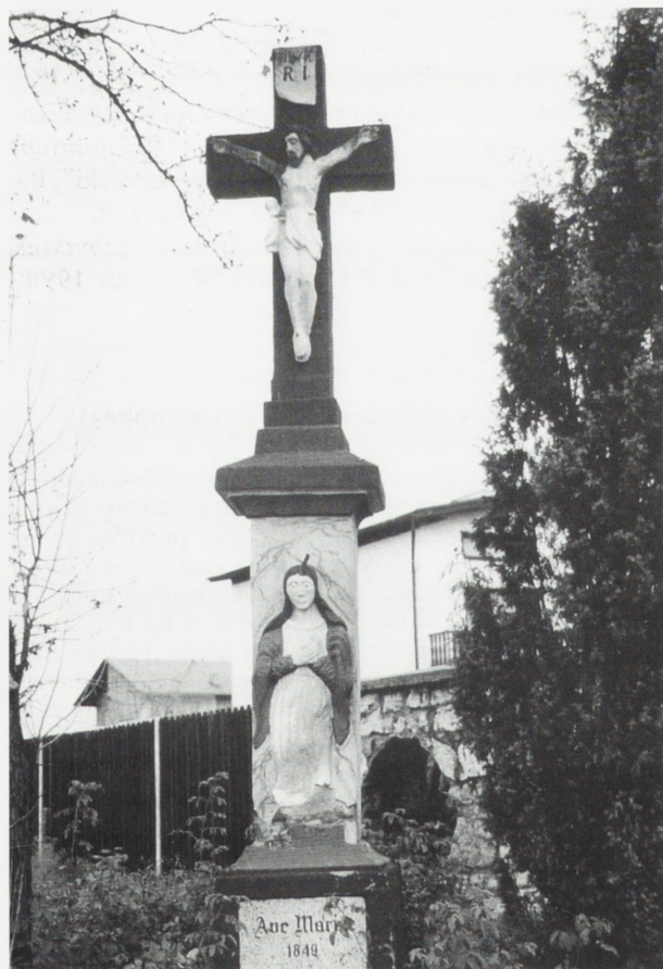
1. Kapliczka Bożej Męki w Tychach z 1820 r. — miejscami widoczne silne zniszczenia spowodowane uszczelnieniem powierzchni piaskowca białą wapienną i podwójną warstwą farby olejnej. Fot. A. Niemczyk-Janik
