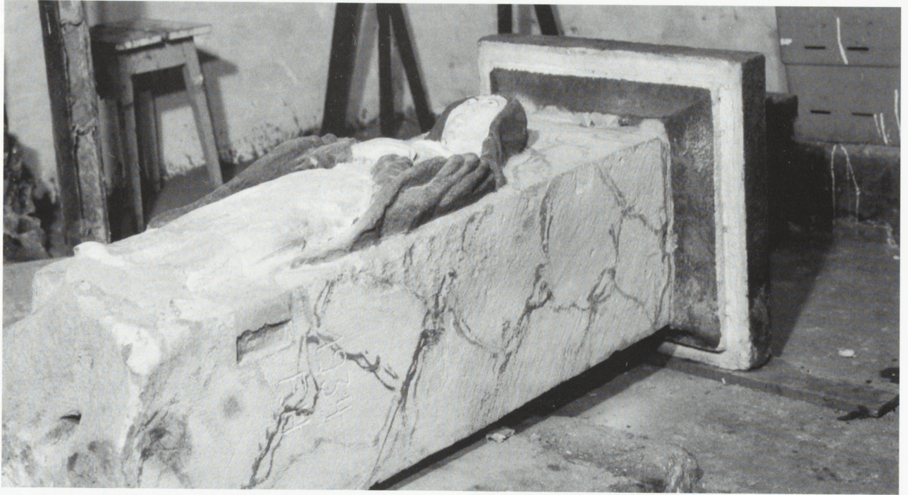
3. Kapliczka z 1820 r. W wyniku rozwiniętych procesów destrukcyjnych nastąpiło oderwanie dużego fragmentu rzeźby. Fot. A. Niemczyk-Janik 3. Shrine from 1820. Destruction caused the dislocation of a large fragment of the statue. Photo: A. Niemczyk-Janik
