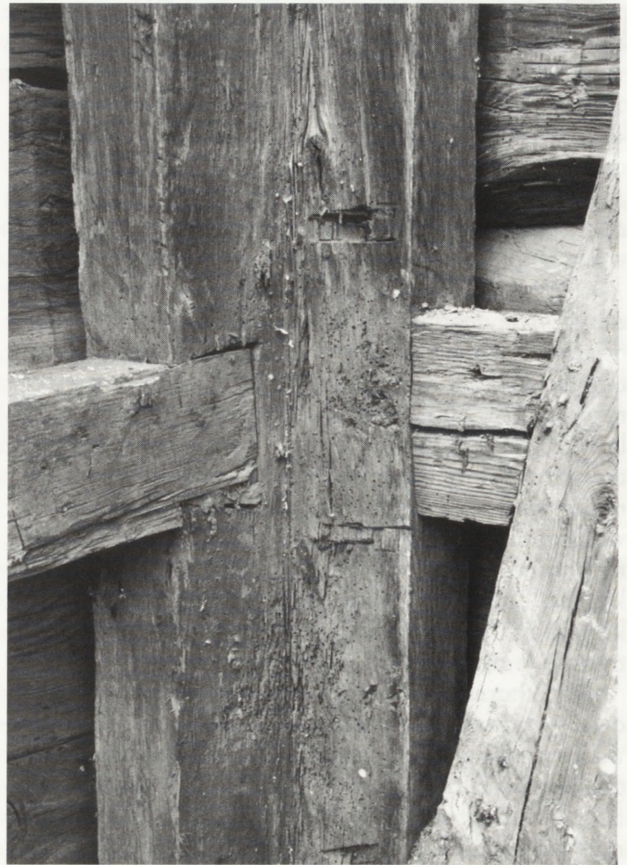
8. Słup narożny konstrukcji szkieletowej przy zwęglowaniu południowej ściany prezbiterium ze ścianą tęczową, stan z 1999 r.
