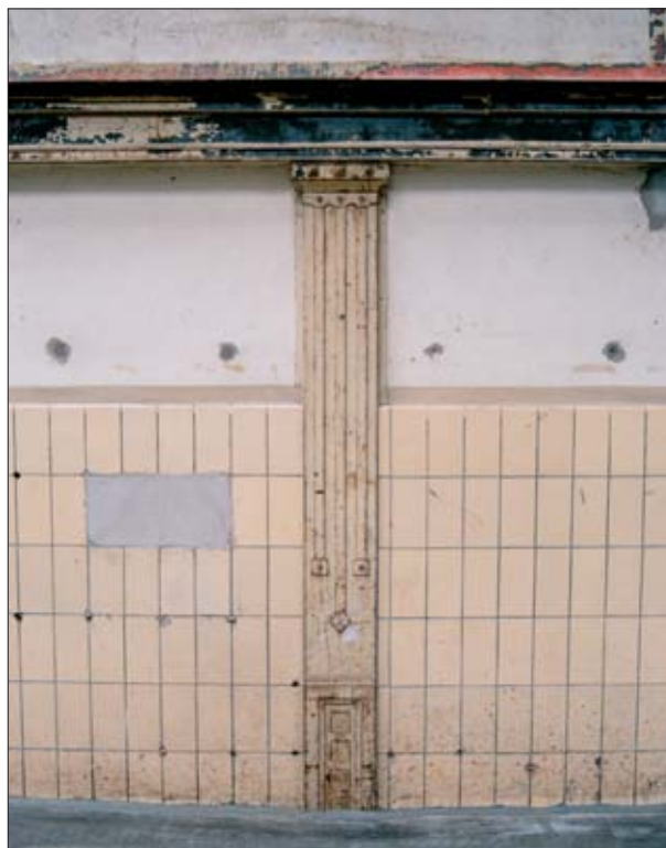
6. Jahrhunderthalle, Bochum, Niemcy, autentyczny detal ściany wewnętrznej z zachowaną patyną – postindustrialna estetyka konserwatorska zastosowana przez biuro projektowe Petzinka Pink Düsseldorf.
