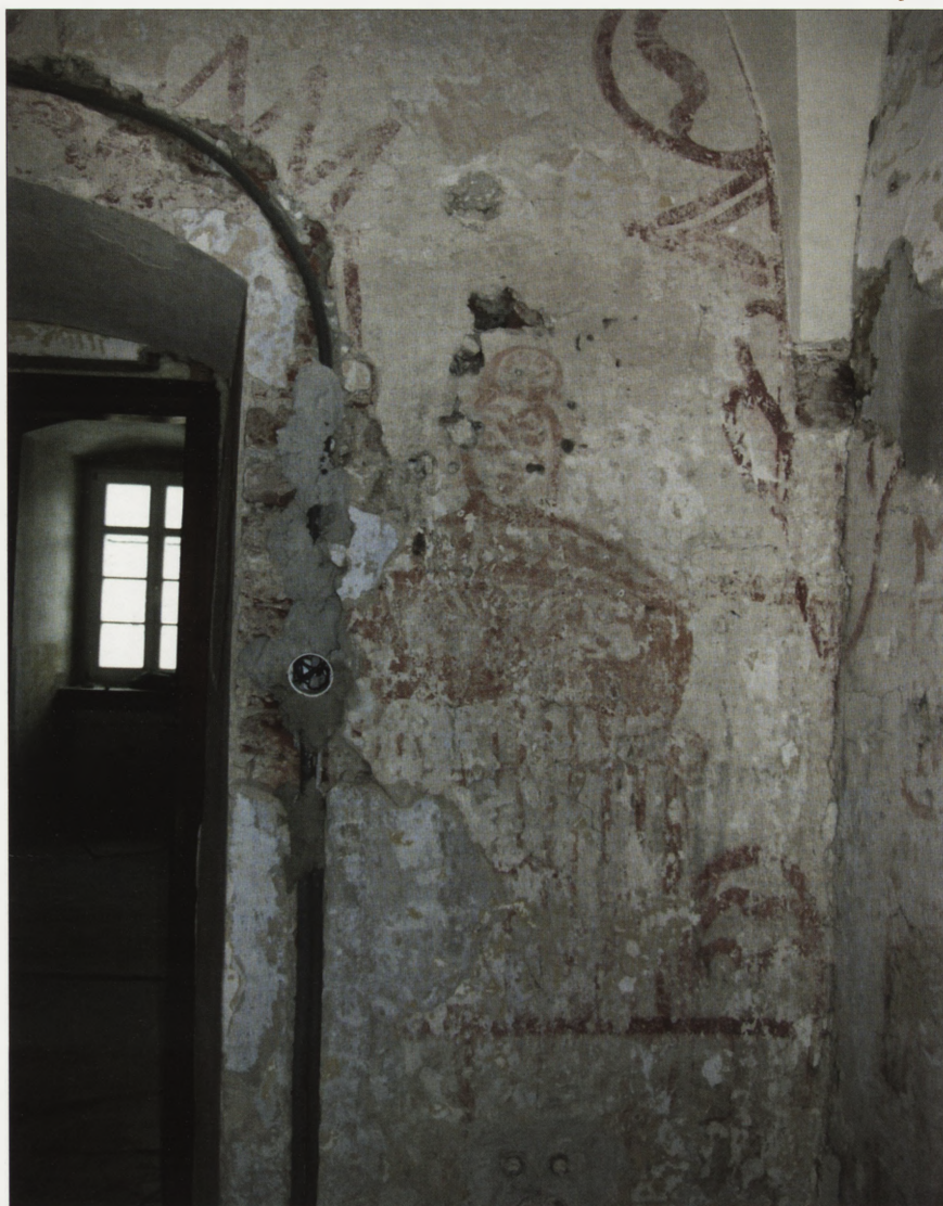
33. Cella nr 3, malowidła ściany wschodniej – stan przed konserwacją. 33. Cell no. 3, murals on the east wall – state prior to conservation.
