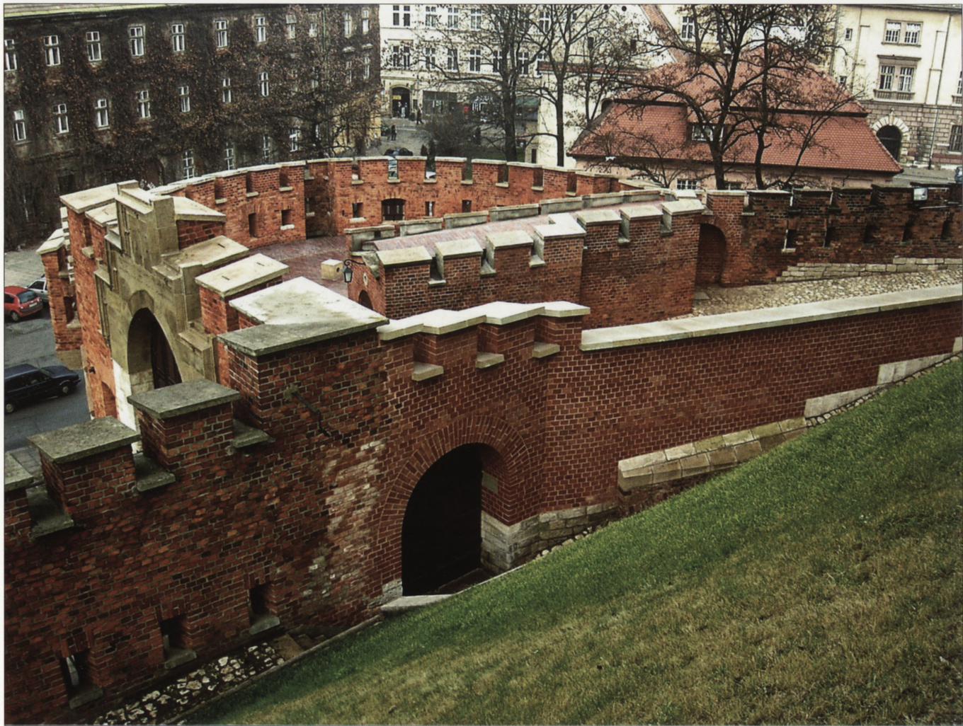
16. XIX-wieczne fortyfikacje austriackie w północno-wschodniej części wzgórza (basteja pod Kurzą Stopką wraz z bramą i przyległe mury obwodowe), stan po konserwacji przeprowadzonej w 2003 r. (proj. Piotr Stępień i Stanisław Karczmarczyk).
