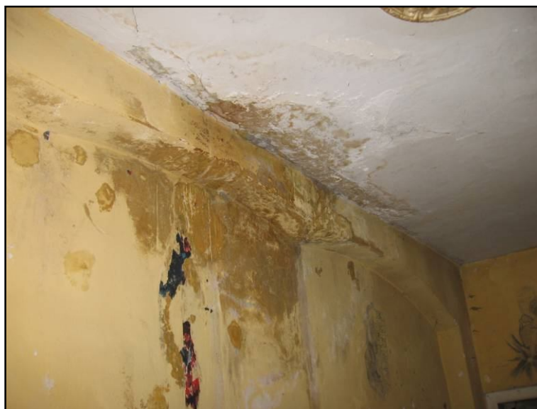
Ryc. 9. Fragment ściany na piętrze jednej z kamienic. Zawilgocenie ściany i stropu z powodu nieszczelności kosza
