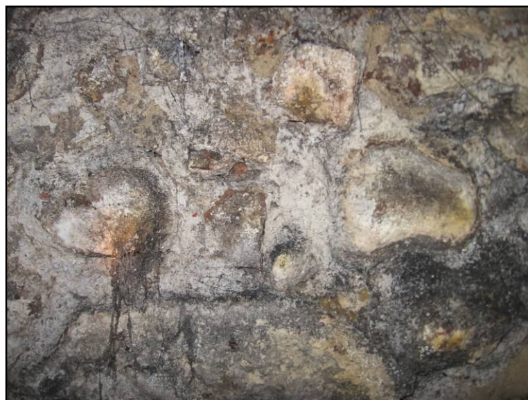
Ryc. 8. Fragment kamiennej ściany piwnic jednej z kamienic. Wysolenia, wykwyty i silne zawilgocenia ścian
