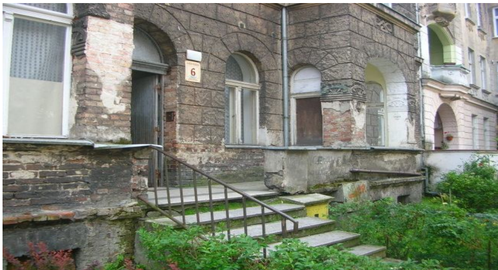
Ryc. 2. Przedwojenne kamienice przy ul. Hołdu Pruskiego, przez dziesiątki lat nieremontowane (fot. autora)
