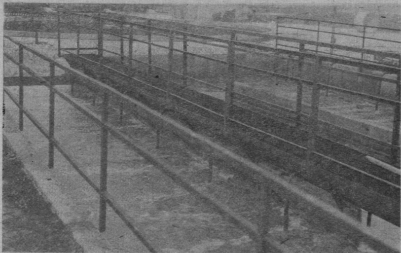
Oczyszczalnia ścieków w Pruszkowie. Na zdjęciu nowa komora osadu czynnego w czasie rozruchu technologicznego.
