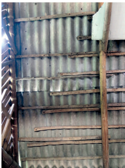
Ryc. 8. Widok na końce oryginalnych łat wzdłużnej połączy dachu od strony wnętrza stodoły, 2023 rok Fot. Anna Ozaist-Przybyła
