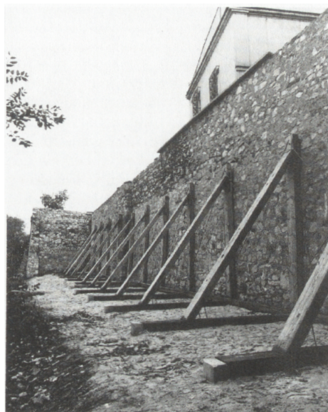
Ryc. 4. Zagrożony odcinek muru okalającego pałacowy ogród od strony ul. Kapitulnej, zabezpieczony stemplami
