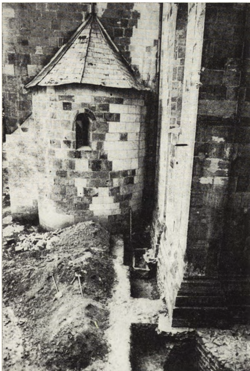
Widok na południową apsydę. Widoczne fundamenty lizen prezbiterium, z których jedna opiera się na romańskim grobowcu
