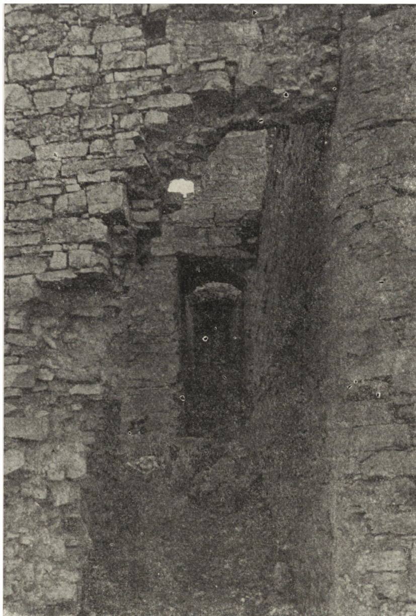
Ryc. 11. Krzyżtopór. Rozwarstwienie muru kazamat dostawionego do północnego barku bastionu III. Widok od zachodu
