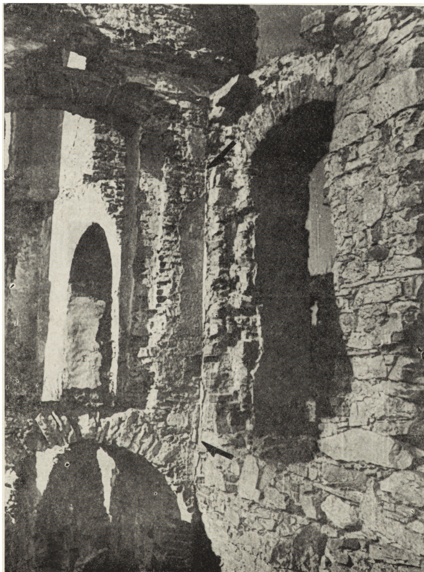
Ryc. 10. Krzyżtopór. Rozwarstwienie muru wieży (widocznego z lewej strony zdjęcia), dostawionego do muru budynku bramnego
