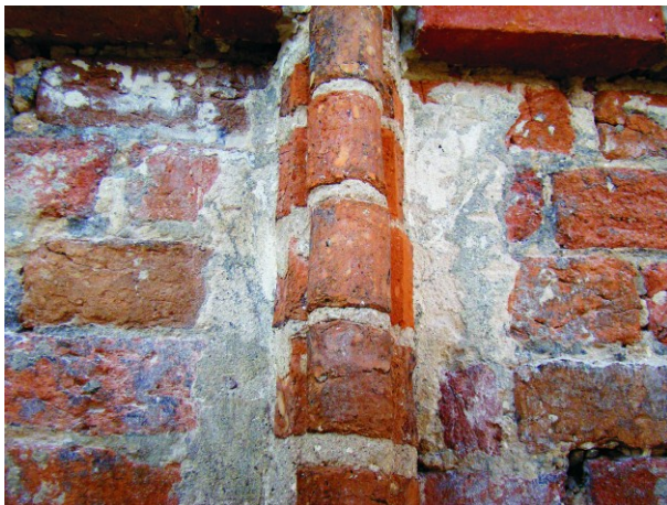
Il. 10. Elewacja frontowa, szczyt, blenda, fragment tynku z rysunkiem maswerku. Fot. Z. Nawrocki 2010
