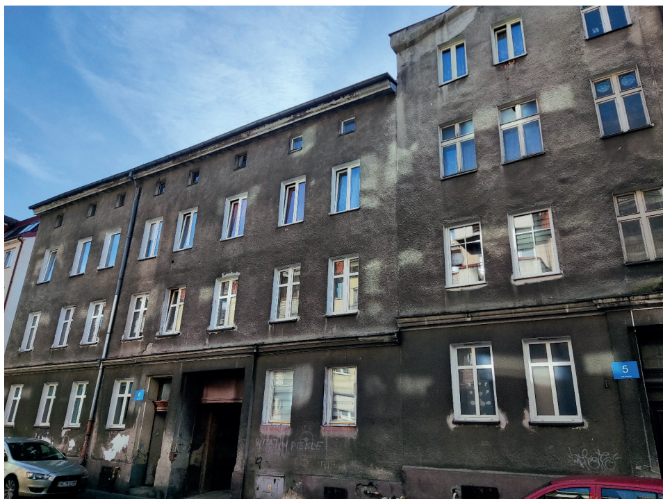
Fot. 8. Nieliczne istniejące do dzisiaj budynki poniemieckie przy ul. Drewnianej w Słupsku; ulica od 1945 r. radykalnie zmieniła wygląd, zatracając pierwotny charakter (zdjęcie autora)
