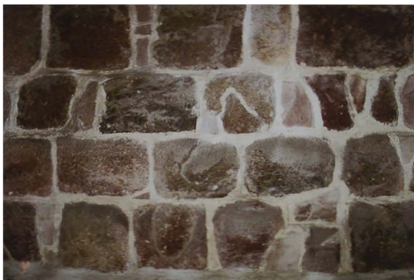
Ryc. 5. Słabo opracowane gązły narzutowe w północnej ścianie wewnątrz kolegiaty
